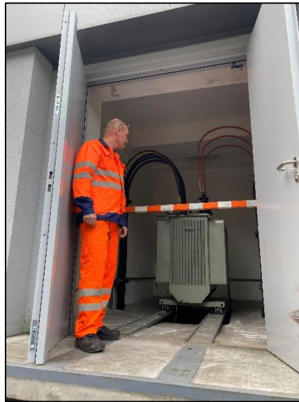
Transformátor 22/0,4 kV 630 kVA
