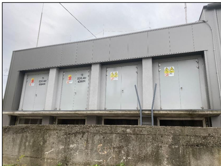
Rozvodna Ostrava hl. n.
