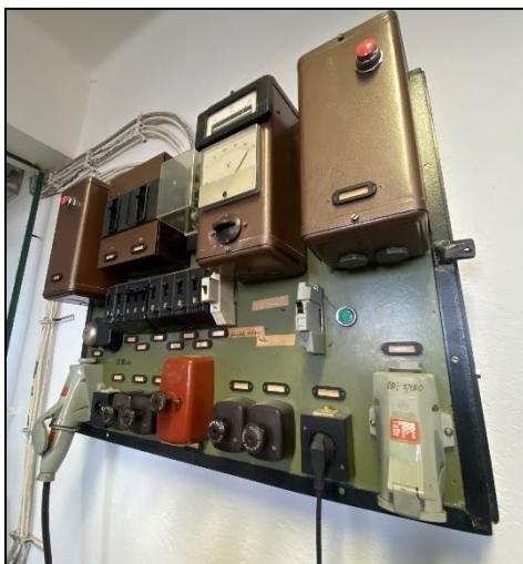
Rozvaděč pro měření
