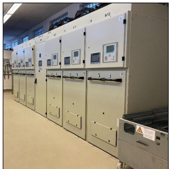
Vnitřní rozvodna 3 kV DC
