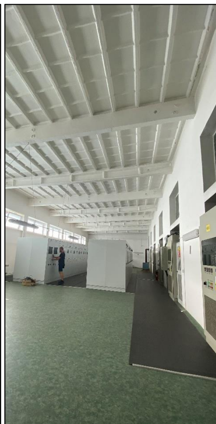
Hala trakční měšírny
