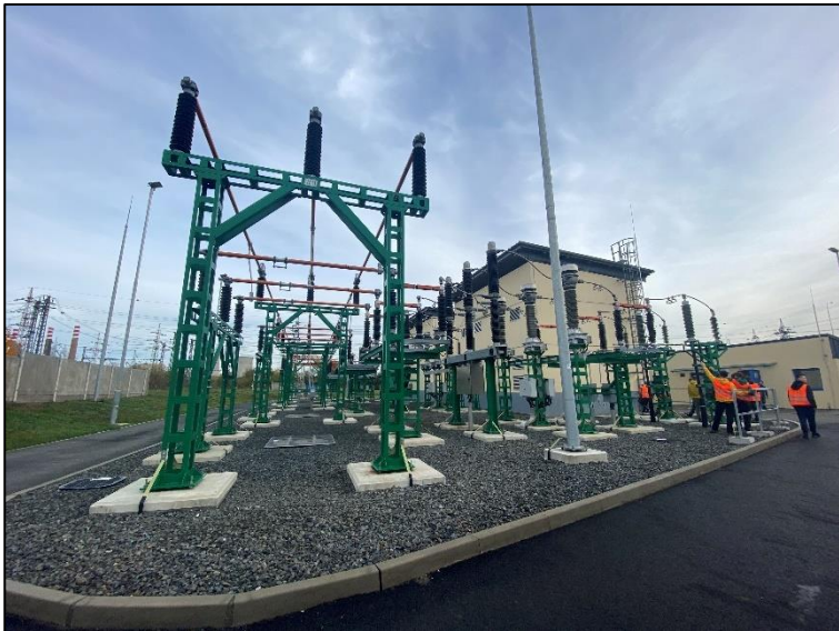
Venkovní rozvodna 110 kV AC
