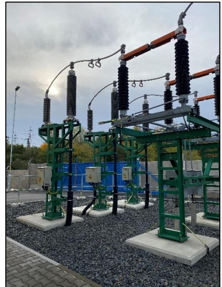
Přívodní kabely z elektrárny Třebovice
