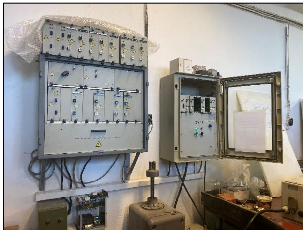
System řízení dálkových odpojovačů – EOMP
