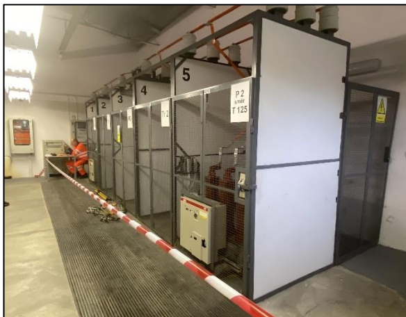
Pětikobková rozvodna VN s podélným dělením
