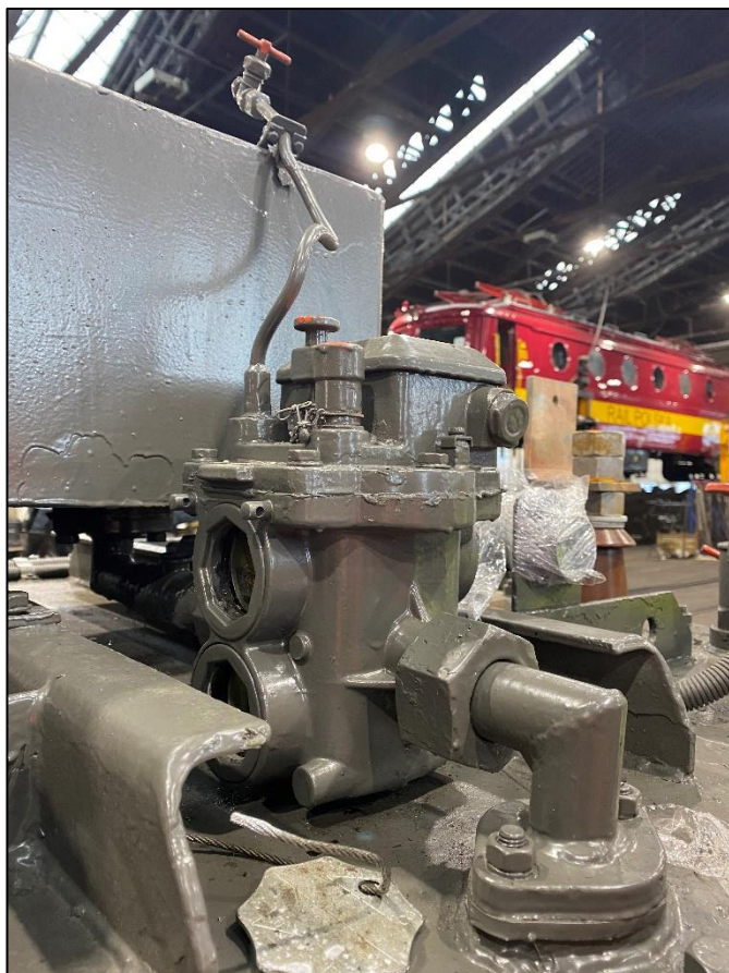
Buchholzovo relé u transformátoru
