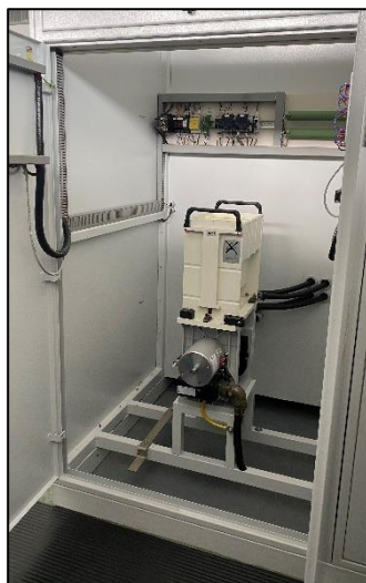
Vypínač v měnírně
