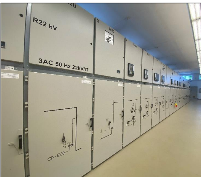
Vnitřní rozvodna 22 kV AC
