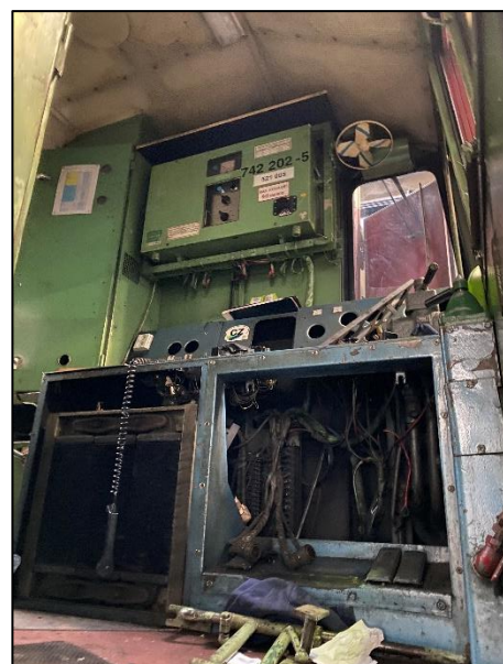
Stanoviště pro demontáž lok. ř. 742
