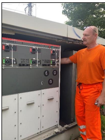
Bloková transformovna TČD 1100 uvnitř
