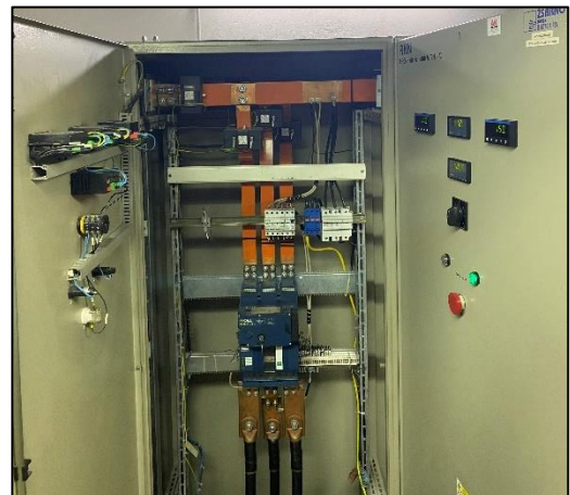
Rozvaděč nízkého napětí
