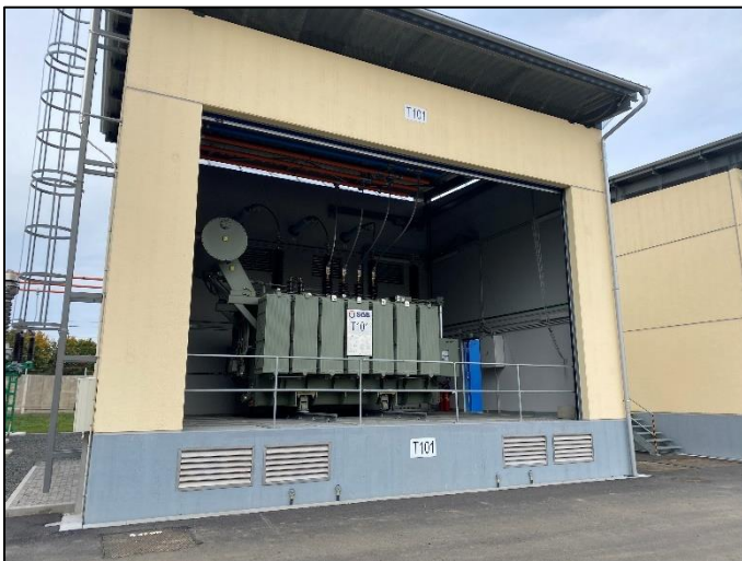
Budova T101 – olejový transformátor 110/22 kV AC
