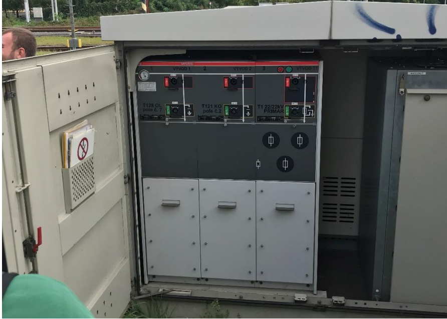
Transformátor 22kV/22kV (galvanické oddělení mezi dvěma napájecími uzly)
